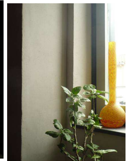
C'est l'épaisseur des murs qui crée une ambiance lumineuse caractéristique du patrimoine ancien
