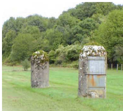
Photographie : Captage d'eau potable
