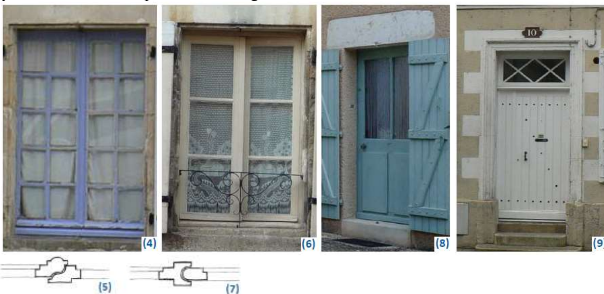
Illustrations 4 à 9 : Illustrations sans valeur réglementaire. Les menuiseries d'origine sont de précieux témoins à conserver et à restaurer.
