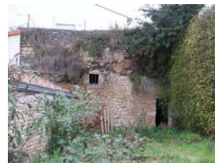
Dépendance troglodyte où corps bâti et rochers ne font qu'un - rue des 4 Cyprès (Buxerolles).
