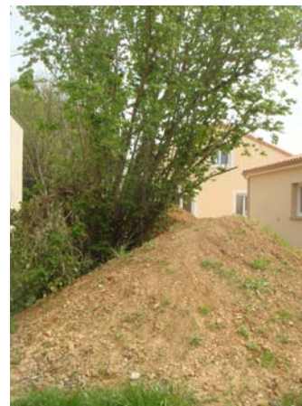
Exemple de non prise en compte des éléments végétaux lors des phases de construction.
