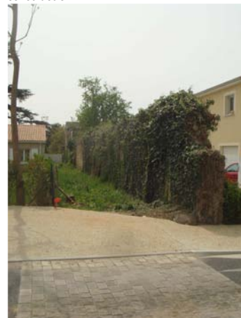
Maintien des éléments patrimoniaux (mur) et végétaux (grimpante) lors de travaux de construction.
